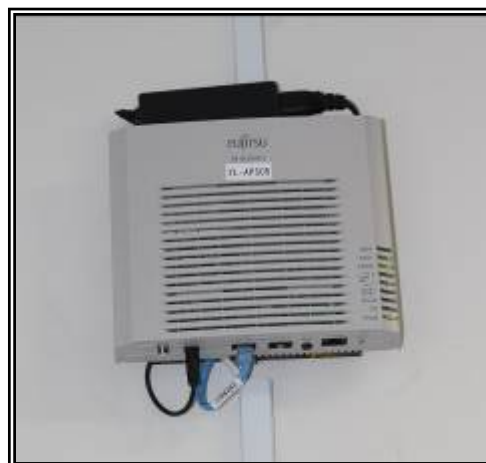
図５ 保健室設置無線 LAN アクセスポイント
