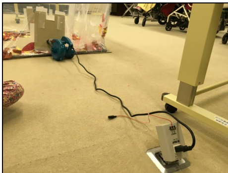
写真5：ブロワと電源リレーの設定
